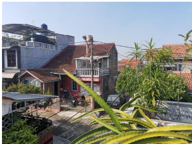
Gambar 1 Ilustrasi Kabel Di Perumahan Sumber: Dokumentasi Pribadi
